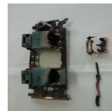
▲コンセント内部の焼け
